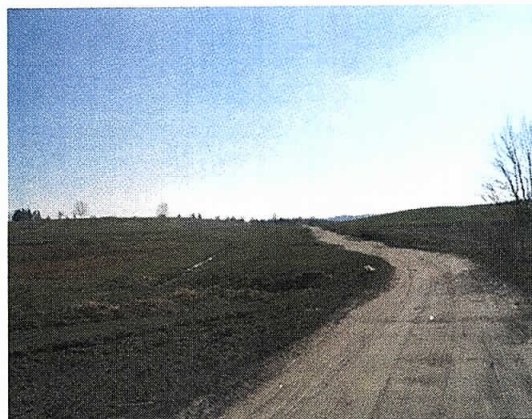
Ustarbowo - stan nawierzchni dróg
